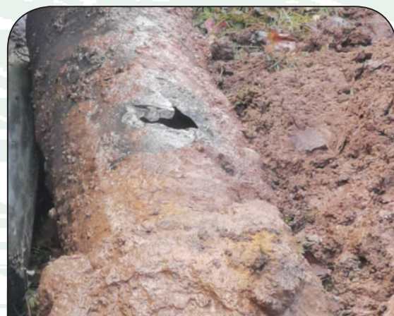
La conduite principale a 70 ans et mériterait d'être remplacée.
