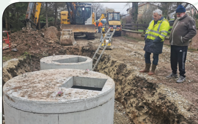
Station de pompage de Bédestroff.
