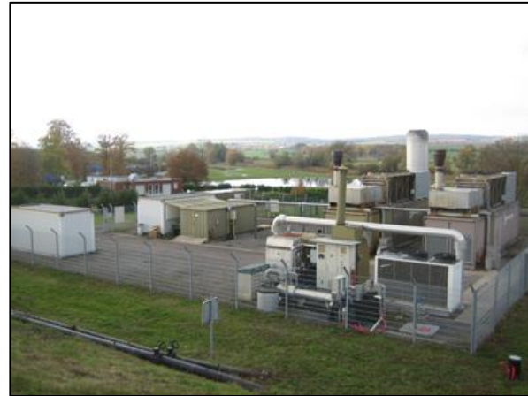
Unité de valorisation du biogaz
