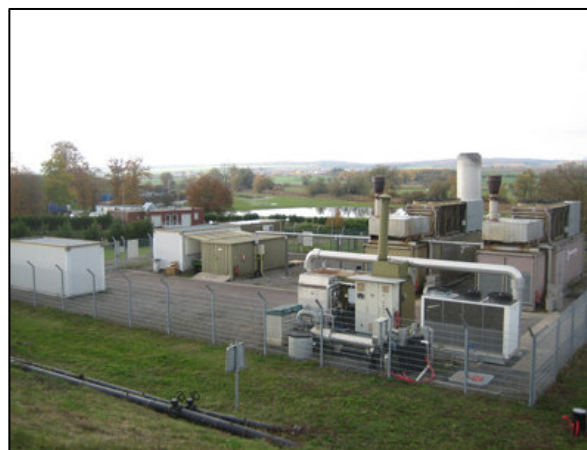
Unité de valorisation du biogaz
